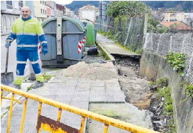
El lugar de la PO-551 donde de produjo la rotura –en la Avenida da Barca– que provocó que se anegasen sótanos en la calle Pazos Fontenla y en el callejón de A Barca. | Gonzalo Núñez
