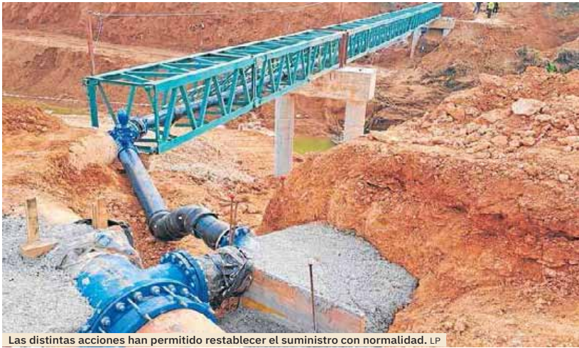
Las distintas acciones han permitido restablecer el suministro con normalidad. LP
